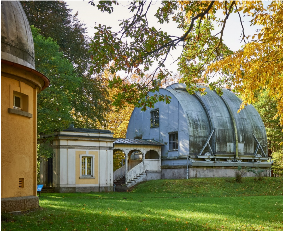
Abb. 4: Gebäude für den Meridiankreis (B1) mit laubenartigem Übergang aus Holz zum Portalvorbau des Dienstraums. Das Tonnendach kann in Nord-Süd-Richtung auf 3m Breite geöffnet werden. Stahlkonstruktion (1907–09), seit 1967 leerstehend, Instandsetzung 2000/03, 2010–12. Foto: Michaela Becker, Oktober 2021
